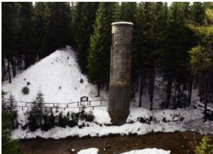
Protržená přehrada na Bílé Desné
